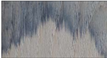
Ausbleichen der Verfärbungen mittels Oxalsäure
