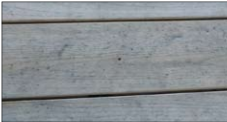
Verfärbungen auf der Holzoberfläche durch Eisenspäne
