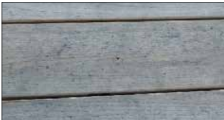
Verfärbungen auf der Holzoberfläche durch Eisenspäne
