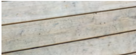
Verfärbungen auf der Holzoberfläche
