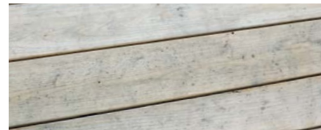
Verfärbungen auf der Holzoberfläche
