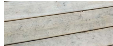
Verfärbungen auf der Holzoberfläche
