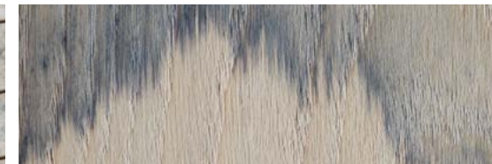
Ausbleichen der Verfärbung mittels Oxalsäure
